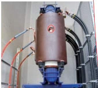
Dieser 1.000-kVA-Gießharz-Transformator mit reduzierten Verlusten steht für höchste Wirtschaftlichkeit.
