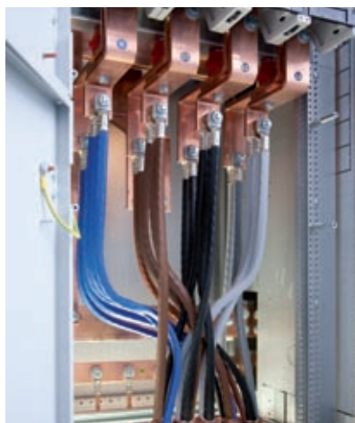
Saubere Arbeit garantiert - auch bei diesem 1.000-A-Abgang für eine neue Kompressorenanlage.
