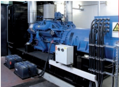
Schutz bei Netzausfällen: Ersatzstrom-Aggregate stellen jederzeit die Stromversorgung sicher.
