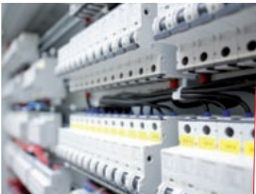
Qualität so weit das Auge reicht - beim Blick in eine unserer Gebäude-Unterverteilungen.
